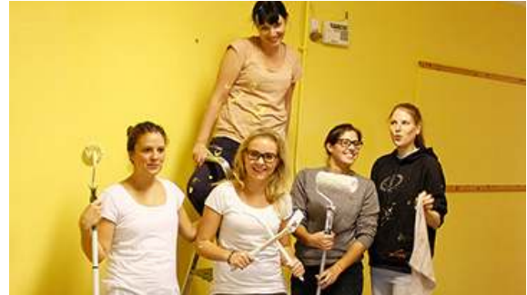
Renovierungsaktion in der Kita „Kinderland Moorburg“ – gestrichen werden zwei große renovierungsbedürftige Räume.
